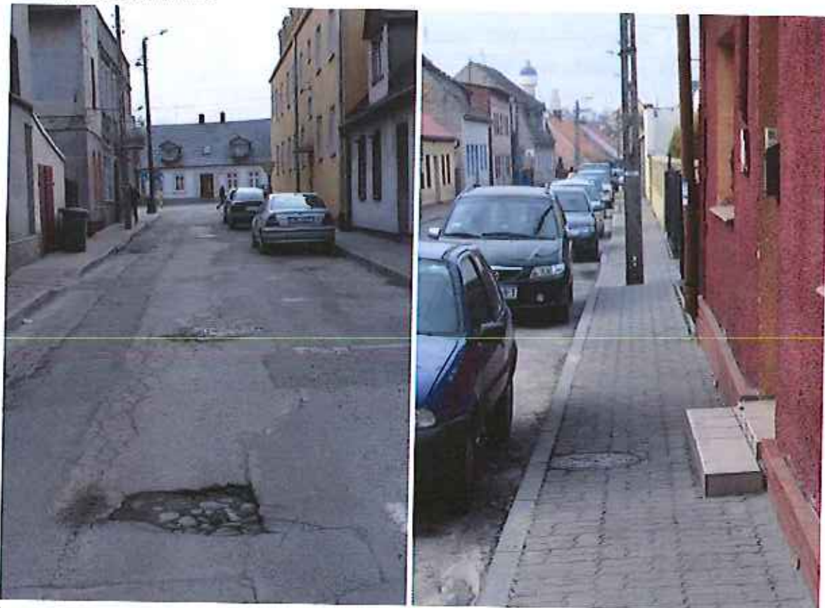
FOT. 2 PRZYKŁADY PROBLEMÓW TECHNICZNYCH W ZAKRESIE INFRASTRUKTURY DROGOWEJ NA OBSZARZE REWITALIZACJI
